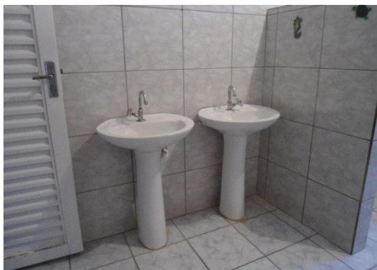
Figura 10: Pia do banheiro II
